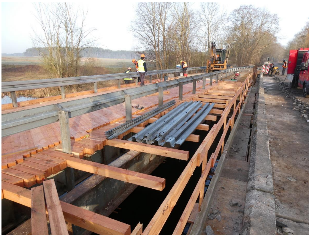
Zdjęcie 3. Most w Żółwinie. Budowa przeprawy tymczasowej. Stan zaawansowania prac na 25.02.2021 r.
