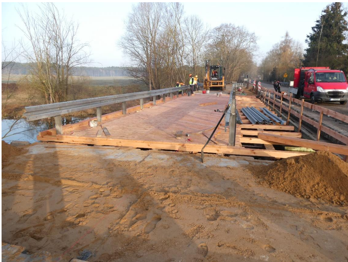
Zdjęcie 1. Most w Żółwinie. Budowa przeprawy tymczasowej. Stan zaawansowania prac na 25.02.2021 r.
