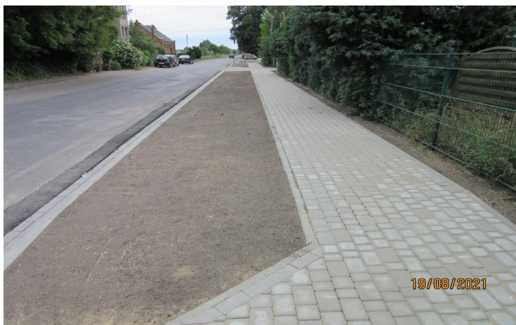
Zdjęcie: Przebudowa drogi powiatowej nr 1358F w m. Trzciel ul. Graniczna – sierpień 2021 r.
