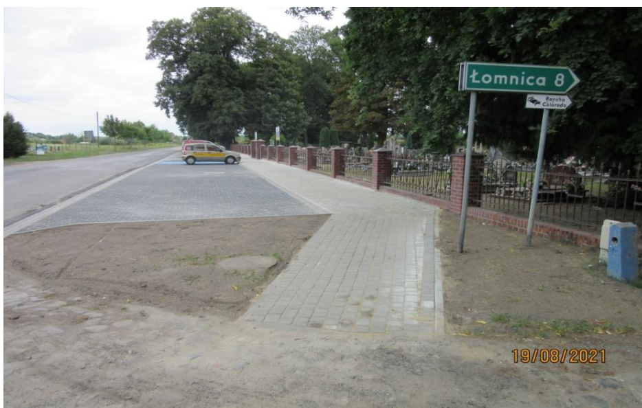
Zdjęcie: Przebudowa drogi powiatowej nr 1358F w m. Trzciel ul. Graniczna – sierpień -2021 r.
