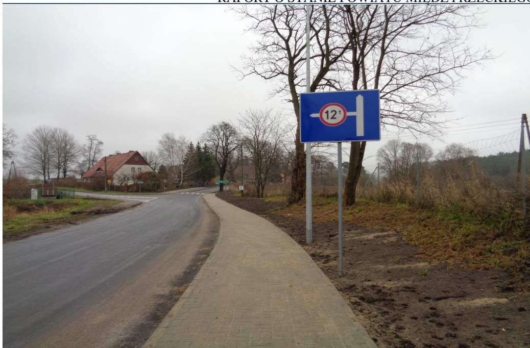
Zdjęcie: Przebudowa drogi powiatowej nr 1337F w m. Pszczew ul. Kasztanowa – 2021 r.
